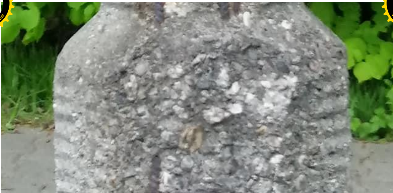
—Wniosek -wymiana-słupów-oświetleniowych-w-dzielnicy-Ligota-Panewniki (6).jpg—
