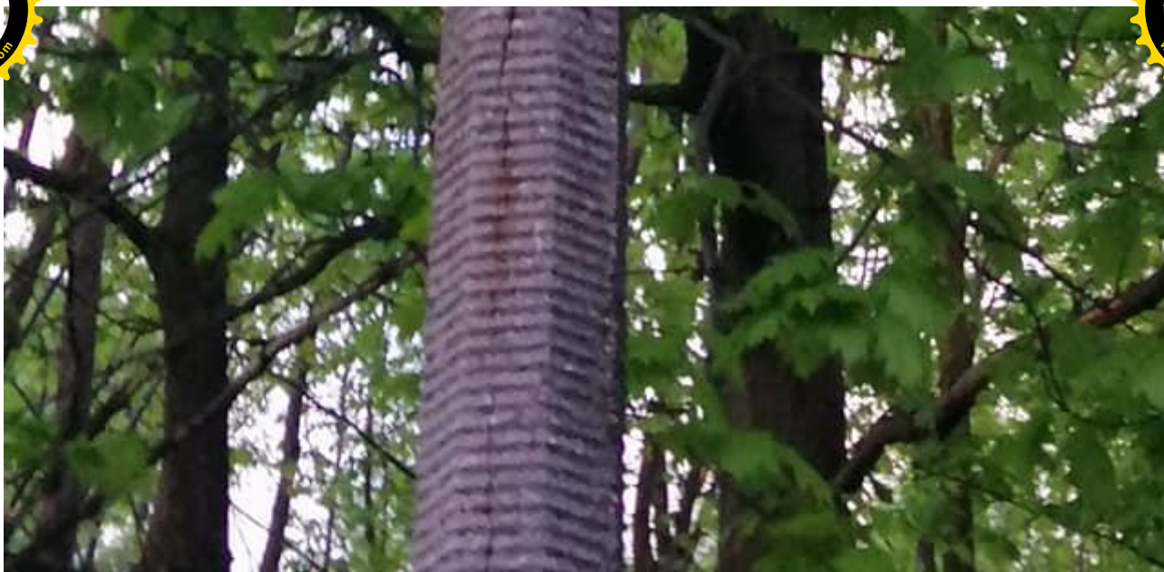
—Wniosek -wymiana-słupów-oświetleniowych-w-dzielnicy-Ligota-Panewniki (12).jpg—
